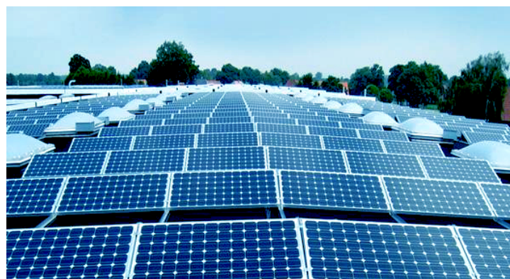
多晶硅电池光伏电站
